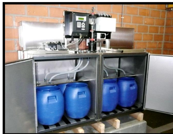
Figure 14 : Dispositif d'échantillonnage automatique des rejets d'effluents liquides à Belgoprocess (site 2)
