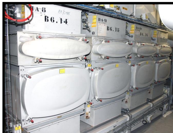
Figure 12 : Caissons de filtration d'aérosols sur un réseau de ventilation de l'IRE, avant rejet à la cheminée
