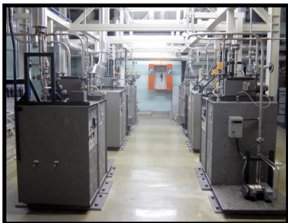
Figure 13 : Dispositifs de contrôle permanent des rejets d'effluents gazeux à la centrale nucléaire de Tihange
