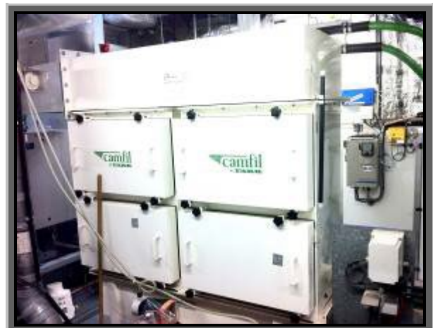
Figure 16 : Caissons de filtration à charbons actifs sur un réseau de ventilation, avant rejet à la cheminée
