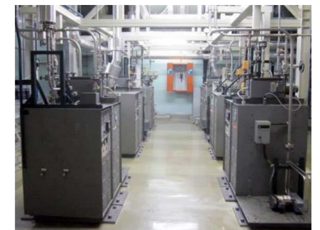
Dispositifs de contrôle en continu des rejets gazeux de la centrale nucléaire de Tihange
