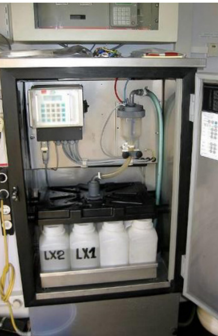
Collecteurs installés dans les containers des balises rivière TELERAD
