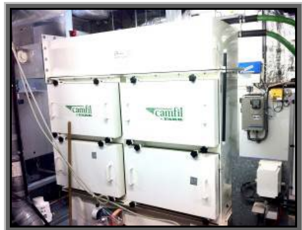
Figure 16 : Caissons de filtration à charbons actifs sur un réseau de ventilation, avant rejet à la cheminée
